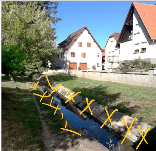
Etat actuel du site : cunette béton avec dépôt sédimentaire et peu de végétation
